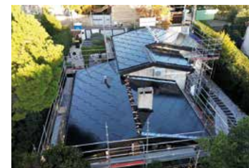
Toiture avec tuiles photovoltaïques.
